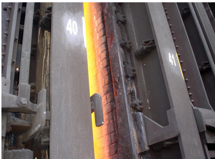
Figura 2. Trincas e desgaste no jamb joint .
